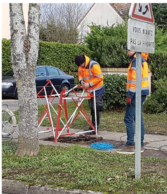
80 % des logements éligibles à la fibre optique
